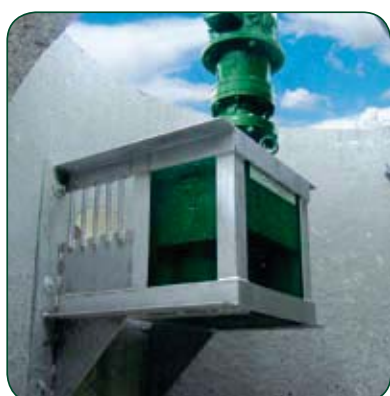
Mini Monster установленный в насосной станции
